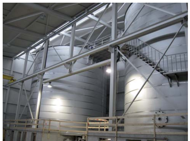
Pumpenvorlagebehälter 2 x 700 m 3 in St. Gallen.
